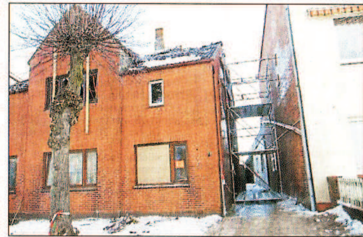
Ein Tag nach dem Unglück: Das Haus ist gegen die drohende Einsturzgefahr gesichert worden. Foto: Hamann
